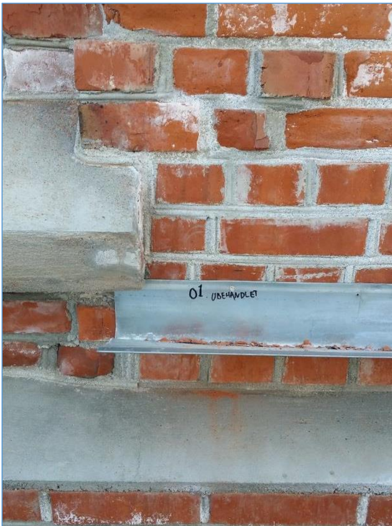
Sammenligning av virkningen av ulike framgangsmåter i mur på Klevfos, for å oppnå kunnskap om materialer og metoder.
