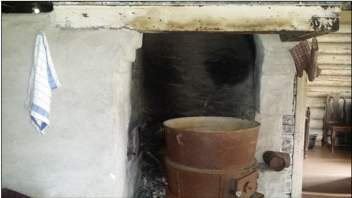
Rekonstruksjon av bakerovn i et fredet hus som er i aktiv bruk til formidling, herunder fyring for baking.
